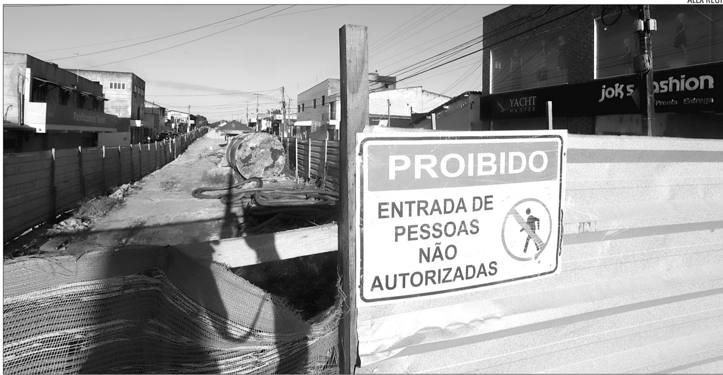
Obras de drenagem começaram em 2013 e sofreram várias paralisações. Além de pendências financeiras, há problemas técnicos
