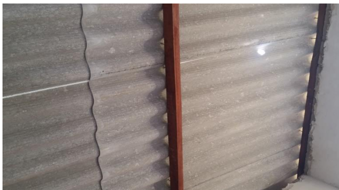
Foto 18 e 19 – telhas quebradas
